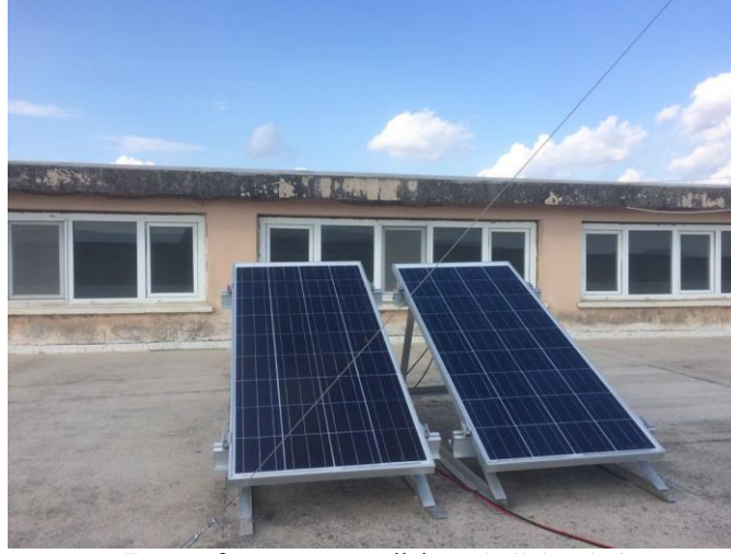
Fotoğraf 1. Güneş enerjisi PV-kollektörleri
