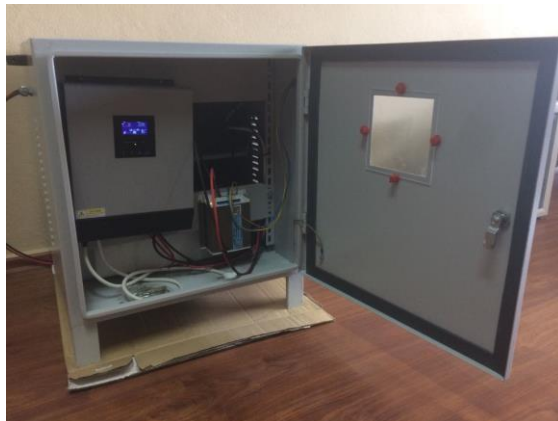
Fotoğraf 4. Güneş-rüzgar hibrid enerji üretim kontrol panosu
